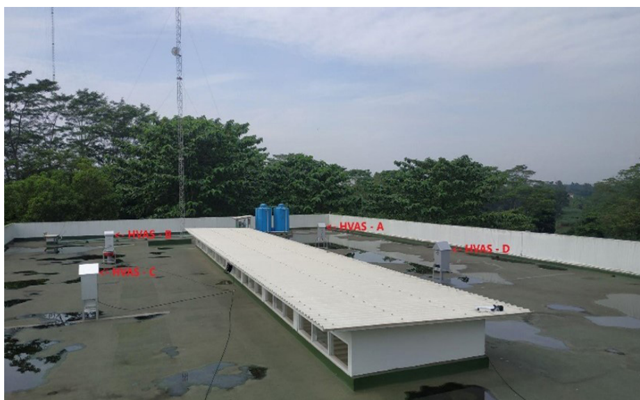
Gambar 2. Penempatan Alat Sampling HVAS di PSIKLH Gedung Metrologi dan Merkuri
